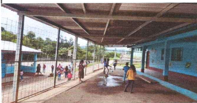
TECHO DEL CORREDOR EN MAL ESTADO SE FILTRA EL AGUA
