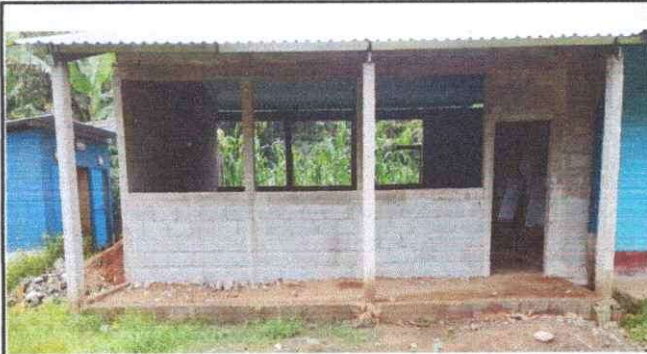
Foto1: AULA AUN NO TERMINADA LE FALTAN VENTANAS, PUERTA
