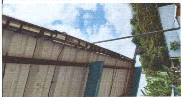
CANALES EN PESIMAS CONDICIONES
